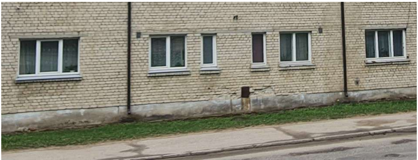
7.att. Rietumu fasādē virs pamata redzams izdrupis mūris, kas līdz ārsienu siltināšanai ir jānolīdzina ar remontjāvu.
