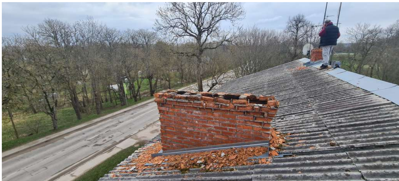
16.att. Redzams jumta segums un skursteņi, kuru gali bojāti, mūris daļēji nobiris; jumta segums jāmaina.
