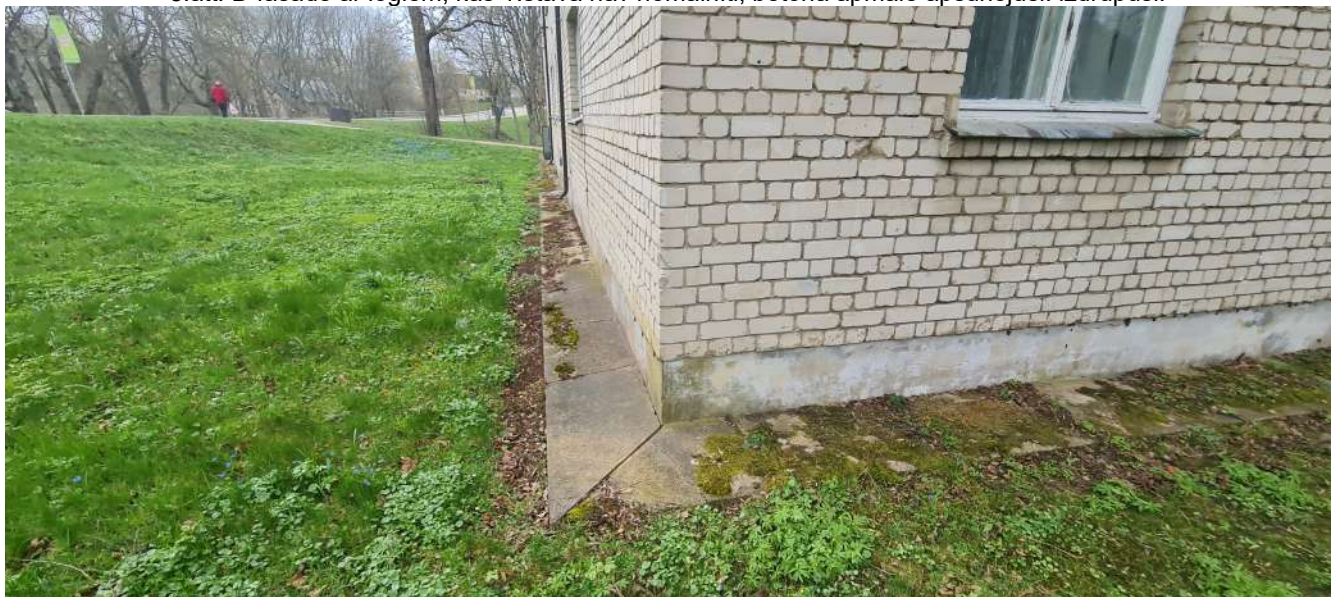
9.att. Palodžu skārds korodējis, atsevišķi logi nav nomainīti; virspamata apmetums nolietojies; betona apmales pēc pamatu siltināšanas jāatjauno.
