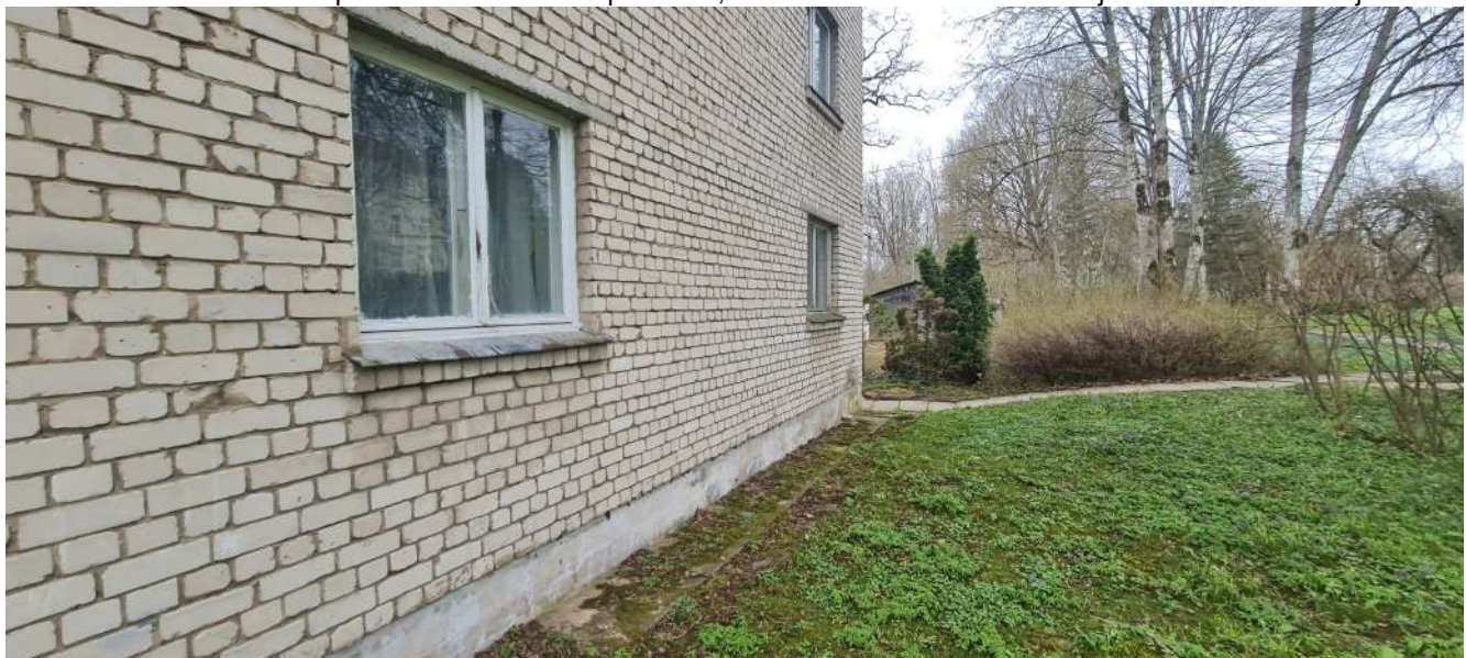
8.att. D fasāde ar logiem, kas 1.stāvā nav nomainīti, betona apmale apsūņojusi. izdrupusi.
