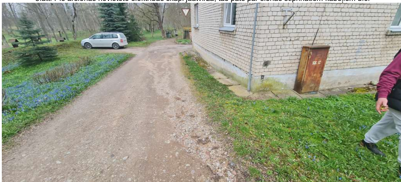
6.att. Pie ārsienas novietoto elektrības skapi jāatvirza; skapis ir korodējis un jāmaina.
