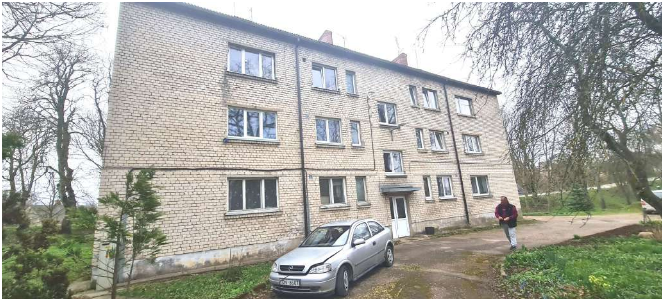
1.att. Dzīvojamā ēka Aizputes ielā 3, Priekulē, 2023.gads, galvenā fasāde, austrumu puse; 3 stāvi, 1 sekcija, 12 dzīvokļi. Kreisā pusē notekas apakšējā zonā redzams mūra bojājums no vecās notekas defektiem; mūris jāremontē.
