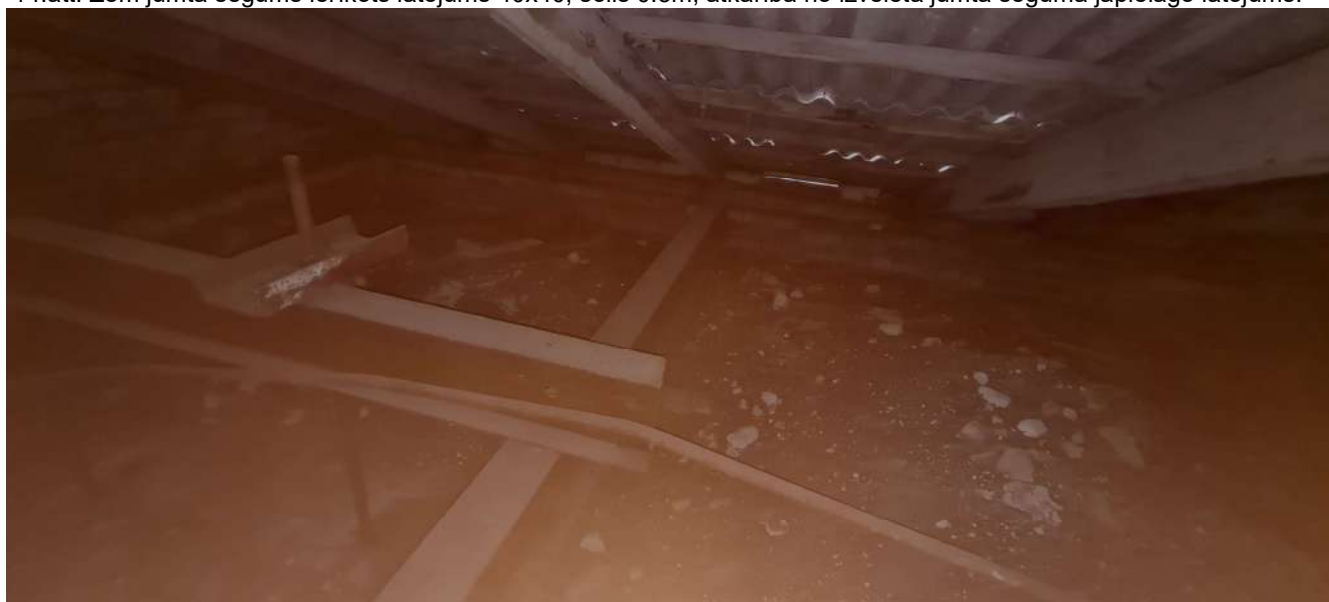
15.att. Bēniņi piegružoti, nav siltināti; jumta segumā ir spraugas, izdrupumi; segums atrodas neapmierinošā stāvoklī.
