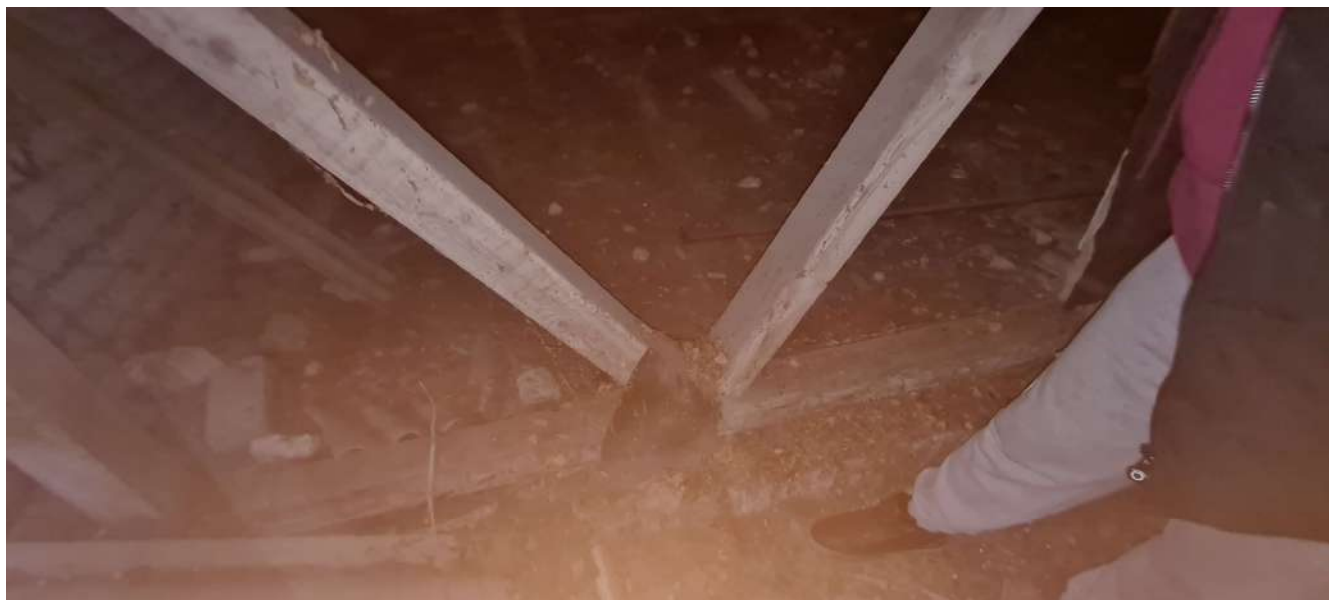
13.att. Jumta nesošās konstrukcijas kopumā atrodas apmierinošā tehniskā stāvoklī; jānomaina trapes bojāti fragmenti.
