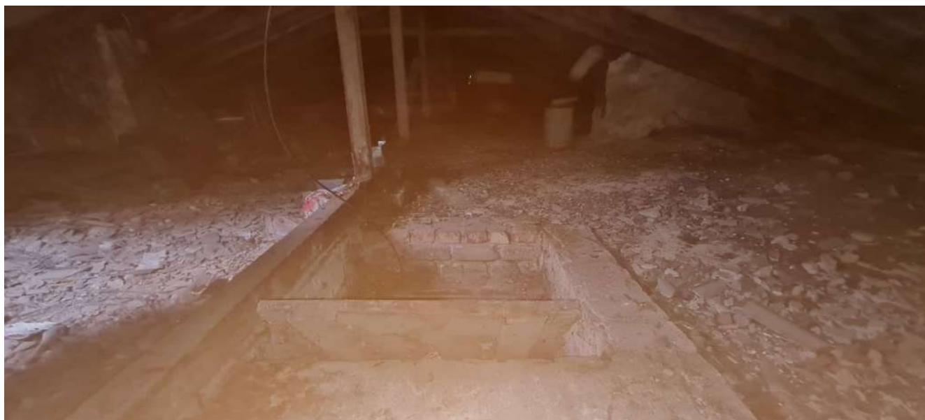
10.att. Bēniņu lūka jānomaina uz ugunsdrošu, esošais siltinājums – izdedži – nav efektīvs; jumts - koka spāru
