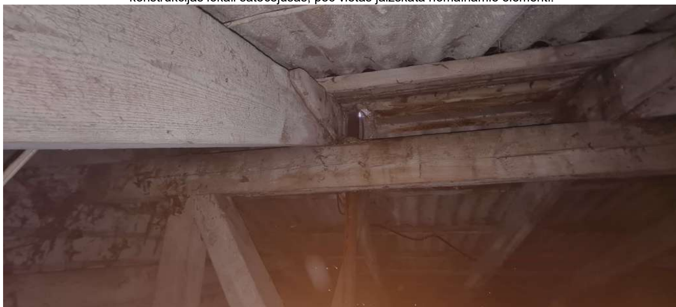
12.att. Jumta nesošās konstrukcijas kopumā atrodas apmierinošā tehniskā stāvoklī; jānomaina trupes bojāti fragmenti.
