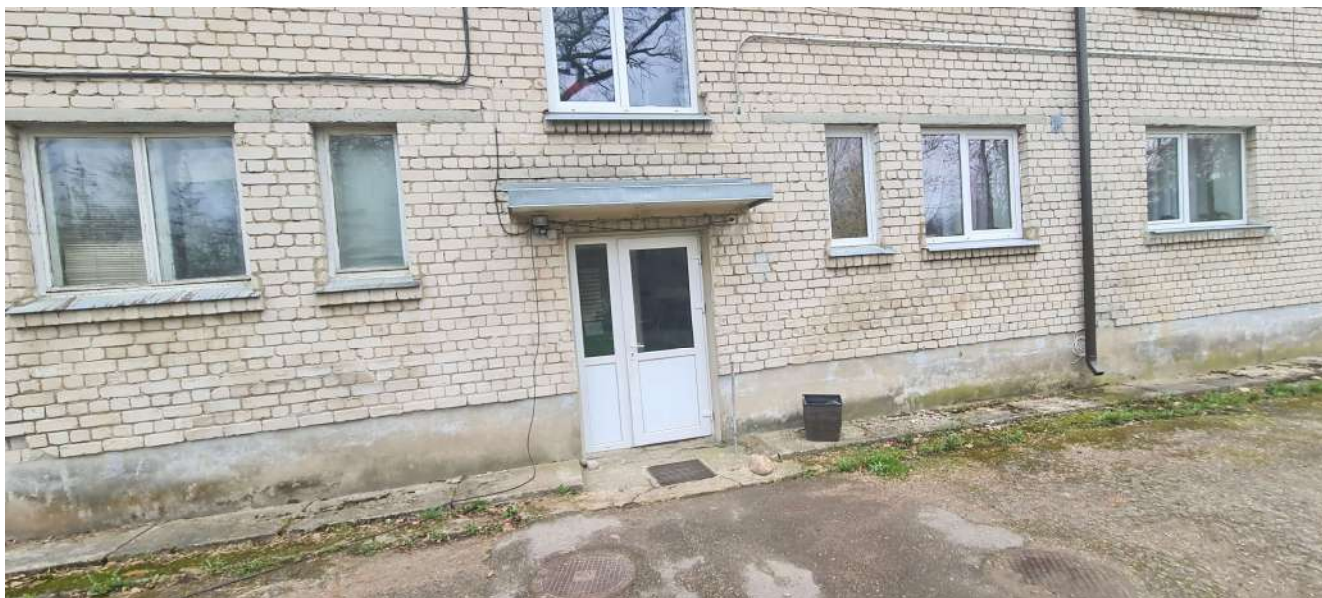
4.att. Jumtiņš virs PVC ārdurvīm remontēts; viršpamata apmetums un apmale gar ēku nolietojusies; notekas un teknes nomainītas; fasādē redzamas dažādas krāsas skārda detaļas. Palodžu skārds korodējis nolietojies.
