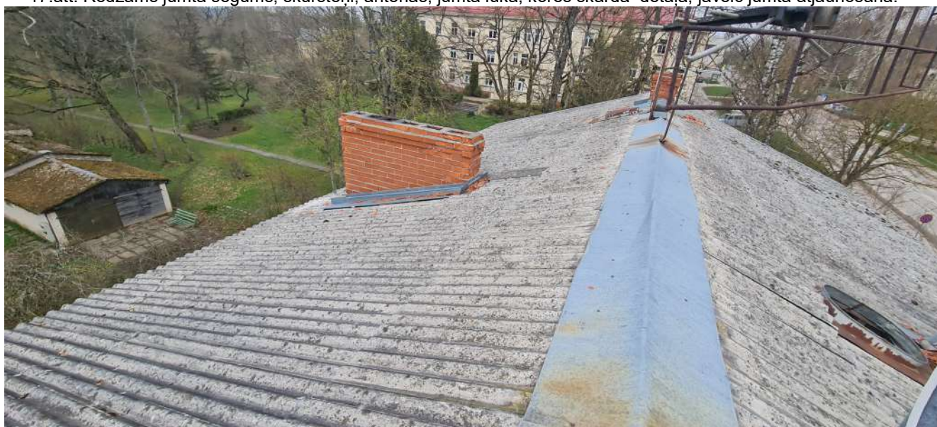
18.att. Redzams jumta segums, skursteņi, antenas, jumta lūka, kores skārda detaļa; jāveic jumta atjaunošana.
