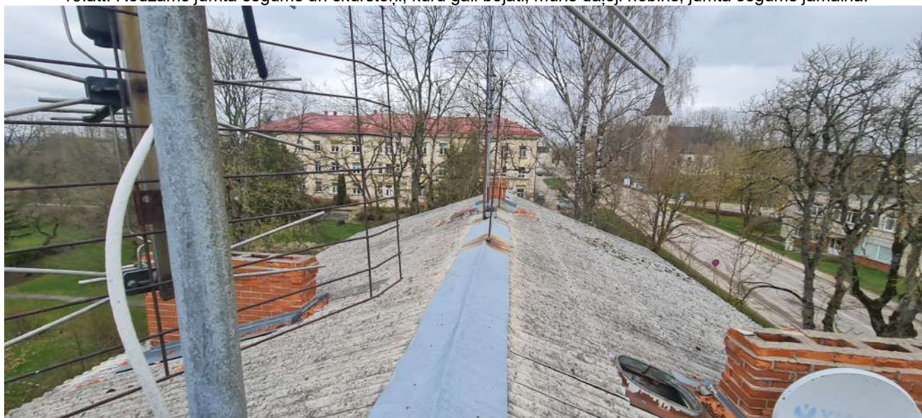
17.att. Redzams jumta segums, skursteņi, antenas, jumta lūka, kores skārda detaļa; jāveic jumta atjaunošana.
